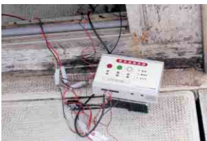
緊急通報システム
